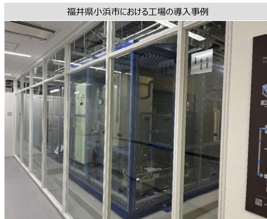
【水素発生装置が組み込まれた設備】
